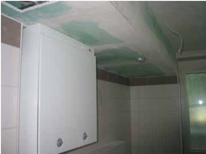
Jednotka vzduchotechniky v koupelně
