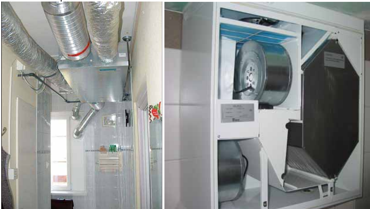
Obr.19: Efektivní větrání prostor lze zabezpečit i decentrálními jednotkami. Umístění jednotky (vlevo) je zde řešeno jednoduchým způsobem do podhledu v prostoru chodby s malými nároky na prostor, s minimálním počtem a délkou rozvodů. Vpravo umístění jednotky v koupelně.
