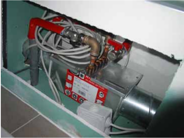
Teplovodní ohřivač přiváděného vzduchu
