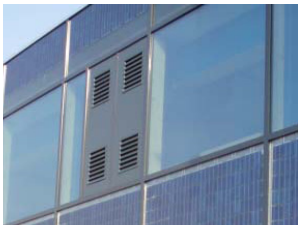
Nasávání čerstvého vzduchu na fasádě
