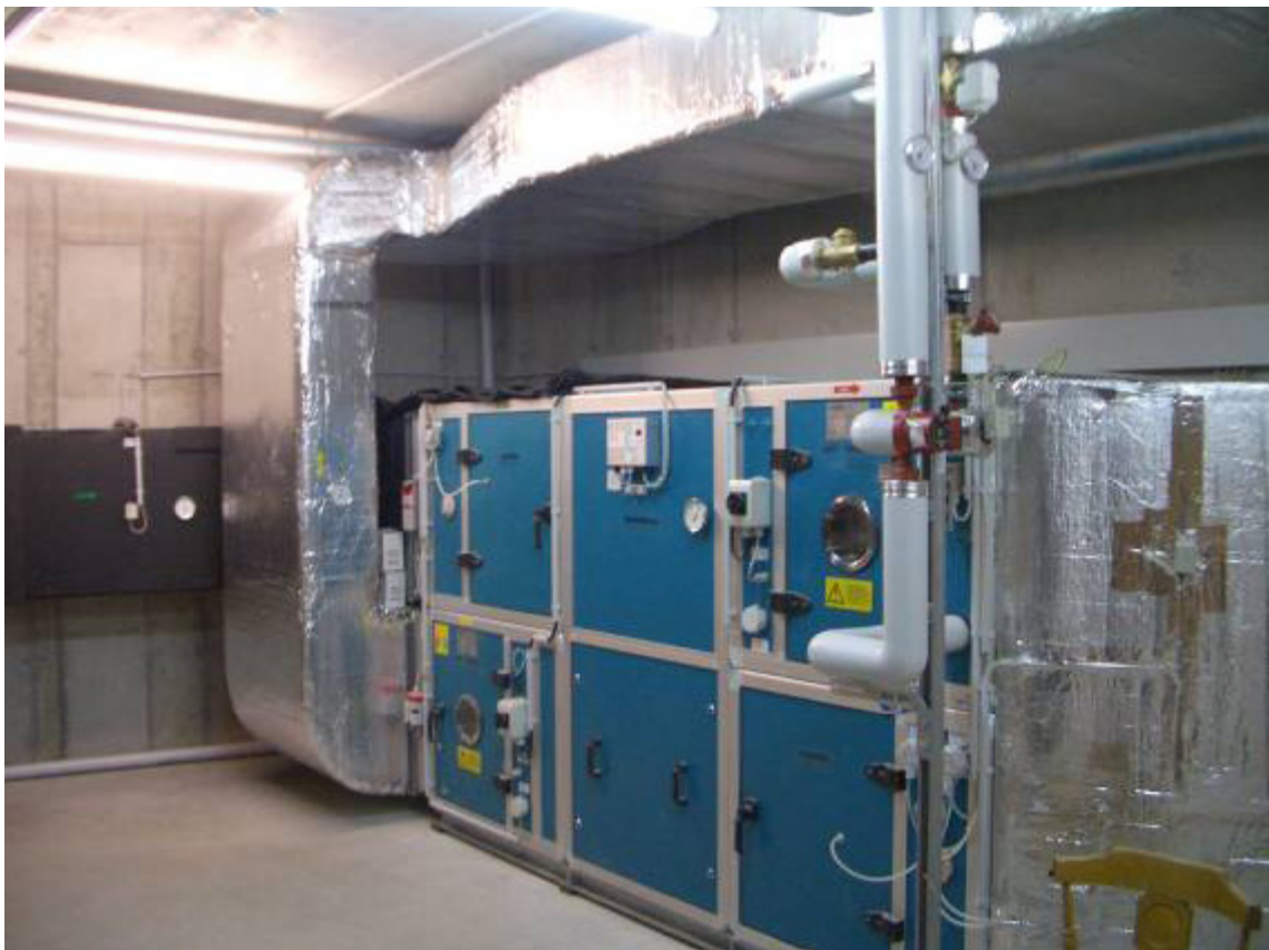
Obr. 10 Centrální větrací jednotka Střední škola Wietau (LLA St. Johann Weitau)
