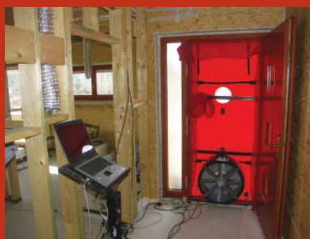
Obr. 6 Zárukou kvality provedení je i test neprůvzdušnosti, kterým se zjišťují při podtlaku či přetlaku kolik vzduchu prochází netěsnostmi v obálce.
