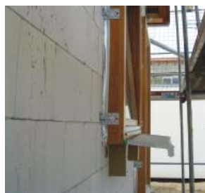
Obr. 6 Před-sazená montáž okna do masivní stavby. Na kotvení se používají speciální rektifikovatelné kotvy, případně ocelové nebo kompozitní úhelníky, které však vyžadují přesnější montáž. Rám okna je následně překryt min. 40 mm venkovní izolace.
