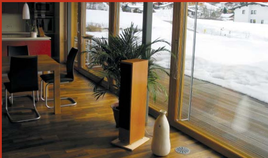
Obr. 1 O kvalitní vnitřní prostředí a neustálý přísun čerstvého vzduchu se stará větrací jednotka. Jediné co většinou z celého systému zůstane vidět jsou vyústky a nasávací ventily, které lze vhodně zakomponovat do interiéru.
