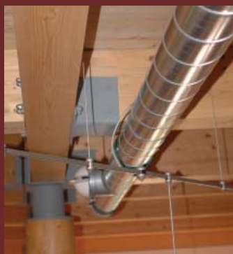
Obr. 11 V některých případech i příznané rozvody vzduchotechniky mohou vypadat v interiéru přirozeně.
