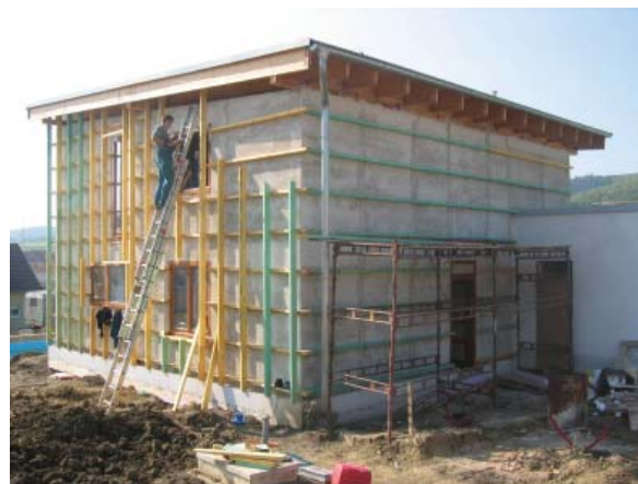
Obr. 3 Do předsazeného roštu z latí kotvených do kříže (na obrázku) nebo I-nosníků se ukládá měkká izolace. Další vrstvy, např. rošt odvětrávané fasády, je možné do těchto prvků kotvit bez vzniku tepelných mostů.
