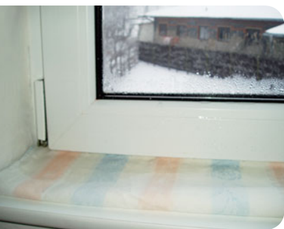
Kondenzace vody v okně
