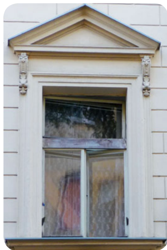
Okno určené k rekonstrukci, nacházející se v památkové zóně historické zástavby
