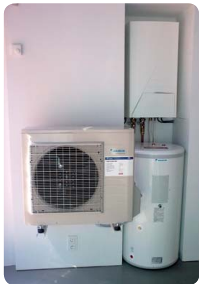
Funkční exponát tepelného čerpadla
