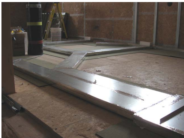
Obr. 87 - Vedení vzduchotechnických rozvodů v tepelněizolační vrstvě podlahy
