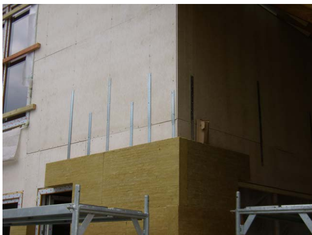
Obr. 78 - Lepení desek z minerální vlny na venkovní opláštění ze sádrovláknitých desek; viditelná ocelová táhla kotvení rámu stěn 2.NP
