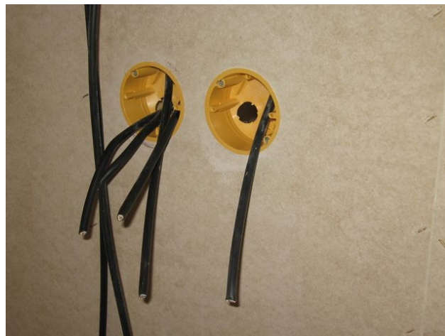
Obr. 86 - Elektroinstalační krabice v sádrovláknité desce
