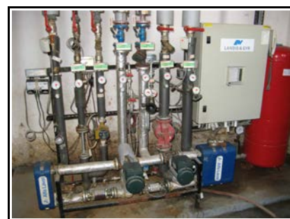
Obr. 10 - Předávací stanice CZT
