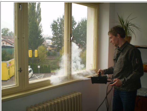
Obr. 41 - Použití kouře při přetlaku v interiéru – kouř uniká netěsnou spárou mezi okenním rámem a okenním křídlem
