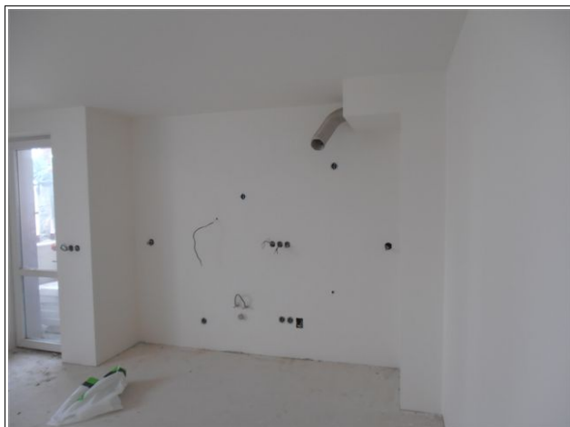
Obr. 21 - Instalace připravené pro umístění kuchyňské linky na mezibytovou stěnu – vysoké riziko snížení vzduchové neprůzvučnosti stěny
