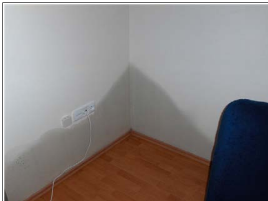
Obr. 4 - Kondenzace vodní páry v koutu u podlahy – bytový dům
