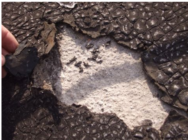
foto /44/ Pokročilá degradace asfaltového pásu na střeše objektu strojovny výtahu - praskliny, perforace, viditelný betonový podklad
