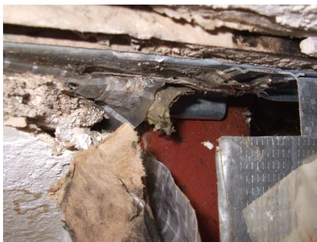
foto /144/ Jedna ze sond provedených do skladby střechy; nesprávné ukončení parozábrany u stěny
