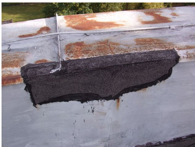
foto /42/ Koroze oplechování atiky; snaha o řešení vlhkostních poruch pomocí navaření asfaltového pásu
