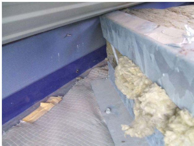
foto /178/ Chybějící lepicí páska v napojení spodní parotěsnicí fólie na navazující konstrukce
