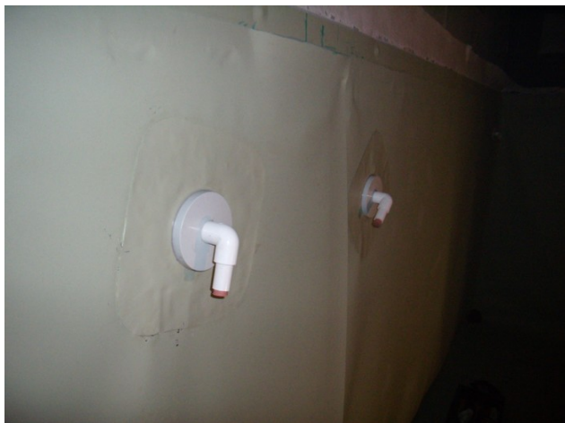
foto /16/ Kontrolní trubice na svislé části hydroizolace
