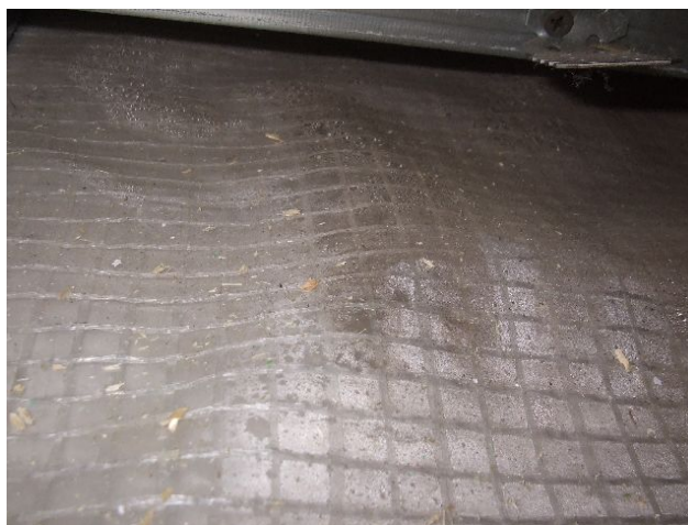
foto /191/ Viditelné stopy kondenzátu na parotěsnicí vrstvě
