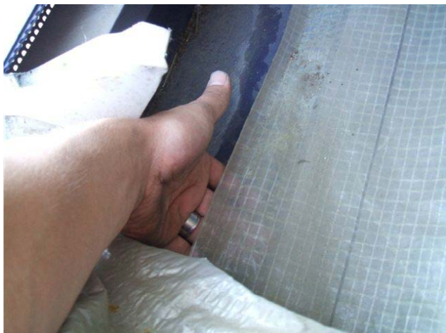
foto /177/ Chybně provedené napojení spodní parotěsnicí fólie na navazující konstrukce
