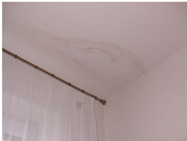
foto /213/ Vlhkostní projevy v koutu nad oknem
