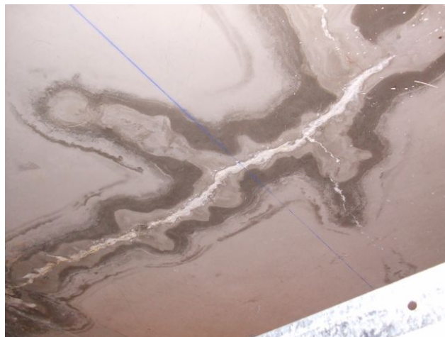
foto /57/ Pohled na vlhkostní poruchy v interiéru
