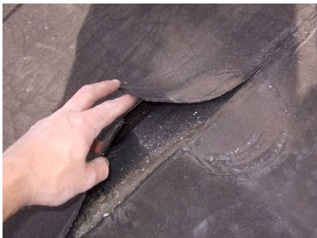
foto /34/ Volný spoj mezi asfaltovými pásy, praskliny na povrchu asfaltových pásů
