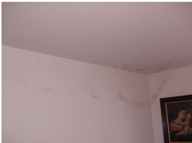
foto /212/ Vlhkostní projevy v koutu místnosti
