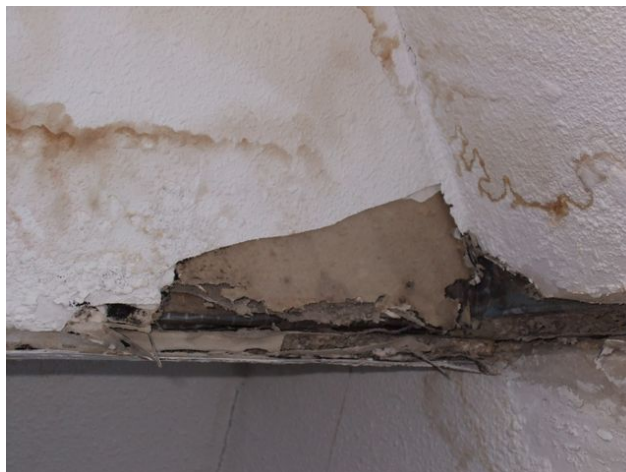
foto /142/ Vlhkostní problémy v interiéru kolem oken
