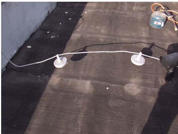
foto /41/ Nedoléhající držáky bleskosvodné ochrany
