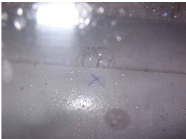
foto /88/ Nalezená a označená netěsnost, projevující se tvorbou vzduchových bublin
