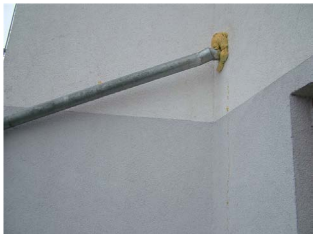
foto /240/ Reálné foto objektu - vstup dešťového odpadního potrubí
