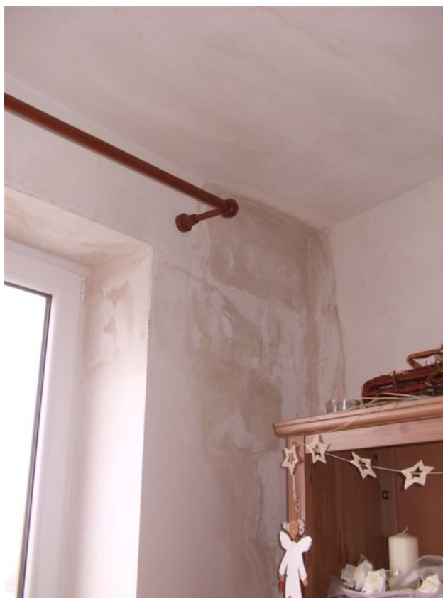
foto /217/ Projevy vlhkostních poruch v interiéru
