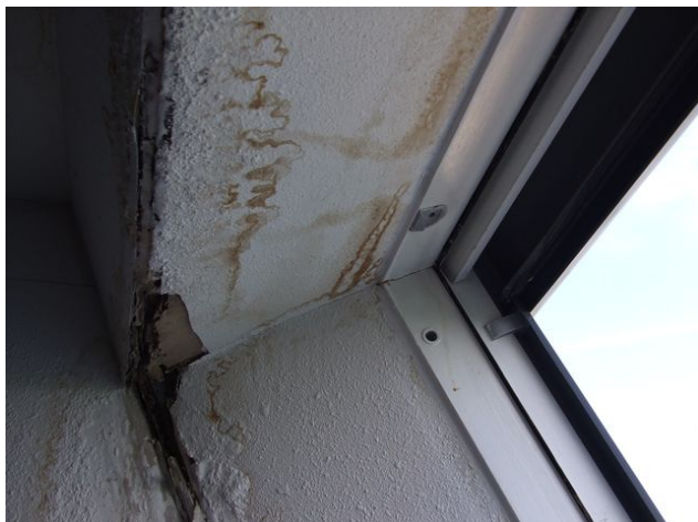
foto /141/ Vlhkostní problémy v interiéru kolem oken
