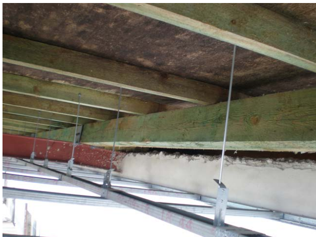
foto /117/ Plíseň na spodním povrchu zákopu
