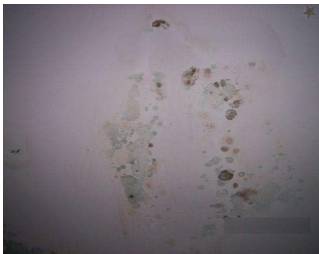
foto /114/ Růst plísní na vnitřním povrchu sádrokartonového podhledu
