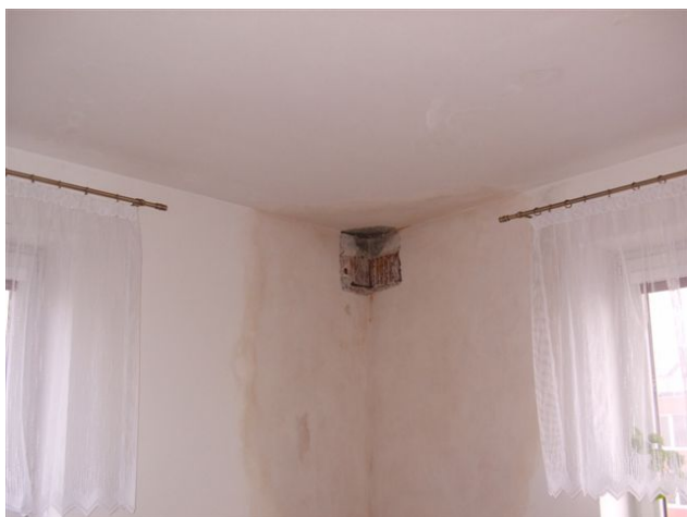
foto /214/ Nově provedena omítka v místech rohu kuchyně s vlhkostními projevy v koutu místnosti
