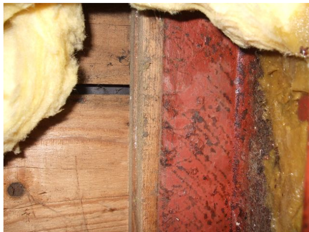
foto /146/ Koroze ocelového nosného profilu, vlhkostí degradovaná tepelná izolace z minerální vlny
