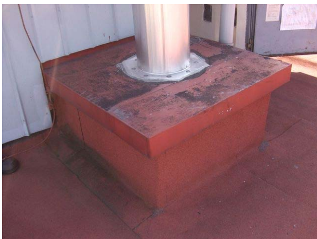
foto /99/ Pohled na VZT komoru
