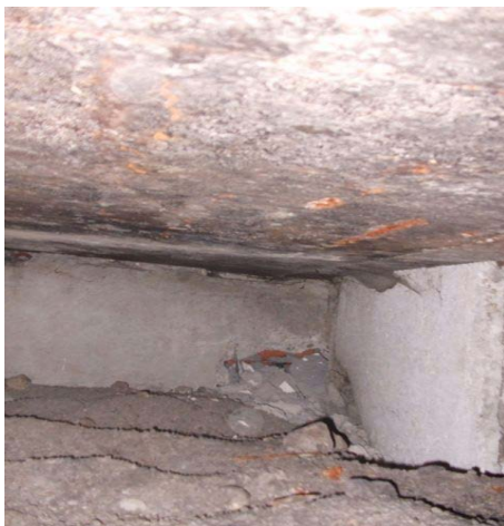
foto /93/ Pohled do provedené sondy s viditelnou degradací krycí betonové vrstvy výztuže
