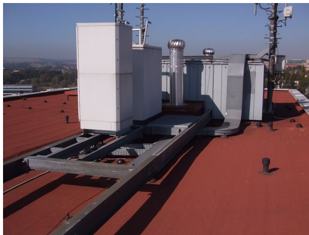
foto /98/ Pohled na předmětnou část střechy – konstrukce telekomunikační technologie
