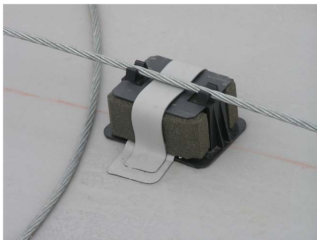
foto /134/ Detail upevnění bleskosvodné ochrany
