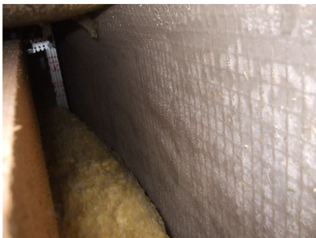
foto /190/ Chybějící tepelná izolace pod vaznicemi, viditelné stopy kondenzátu na parotěsnicí vrstvě
