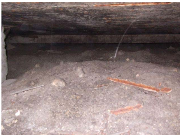
foto /95/ Pohled do vzduchové mezery v provedené sondě s odpadávající výztuží
