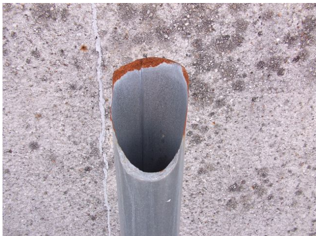
foto /40/ Chybějící stříška potrubí odvětrání kanalizace
