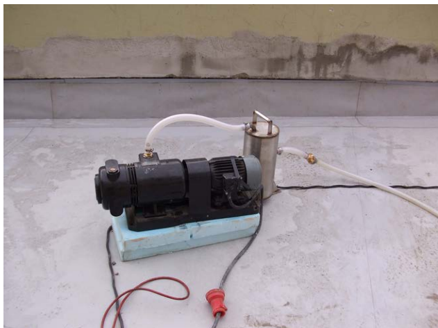
foto /86/ Pohled na vývěvu a odlučovač vody
