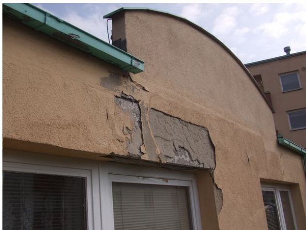
foto /56/ Vlhkostní poruchy v exteriéru
