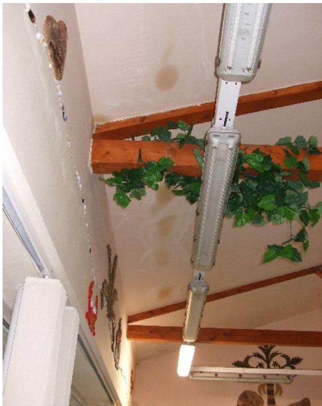
foto /184/ Vlhkostní projevy v interiéru
