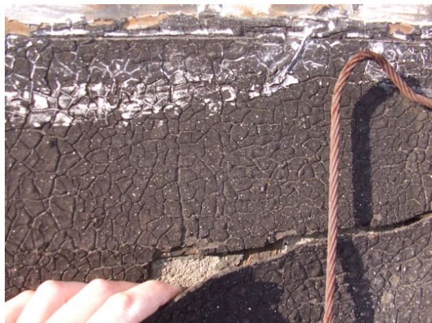
foto /45/ Pokročilá degradace asfaltového pásu na střeše objektu strojovny výtahu - prasklina v místě ukončení okapnice u okapu
