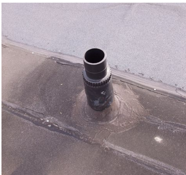
foto /38/ Chybějící stříška odvětrávacího komínku
