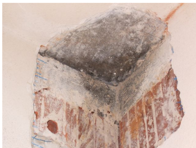
foto /215/ Pohled na kout s odstraněnou omítkou, na povrchu železobetonového věnce značná vlhkost
