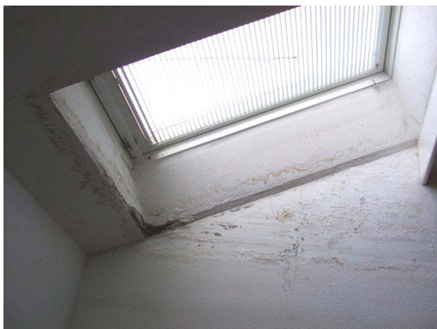
foto /139/ Vlhkostní problémy v interiéru kolem oken
