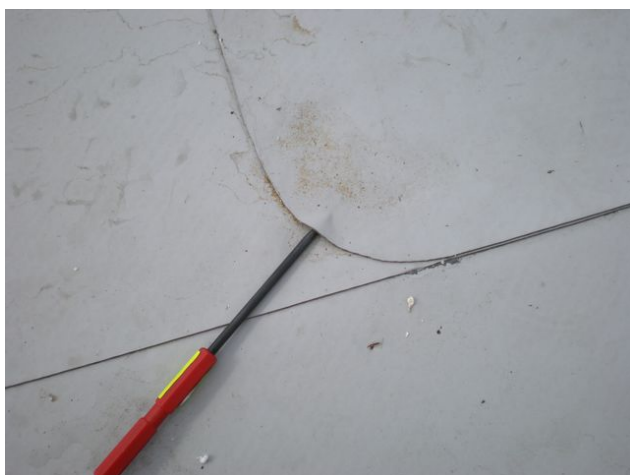
foto /84/ Nalezená netěsnost ve spoji hydroizolace pomocí jehlové zkoušky
