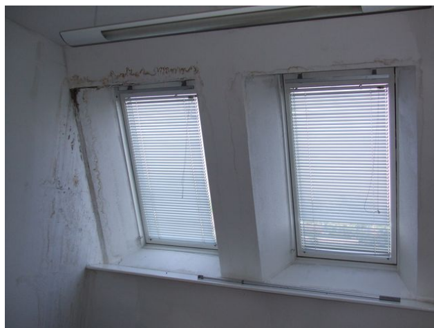
foto /140/ Vlhkostní problémy v interiéru kolem oken
