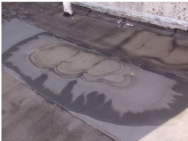
foto /36/ Prohlubně na povrchu hydroizolace s viditelnými stopami po existenci louží
