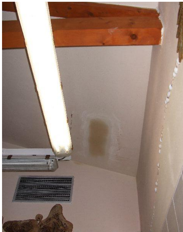
foto /185/ Vlhkostní projevy v interiéru
