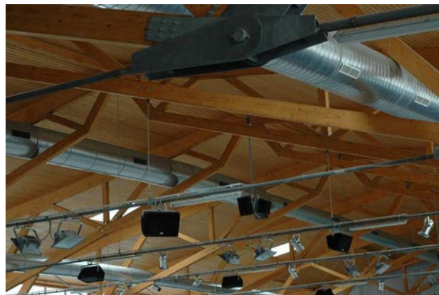
foto /161/ Podhled s odváděcím (v hřebeni) a přiváděcím (po stranách) potrubím vzduchotechniky, osvětlení je zavěšeno na ocelových táhlech
