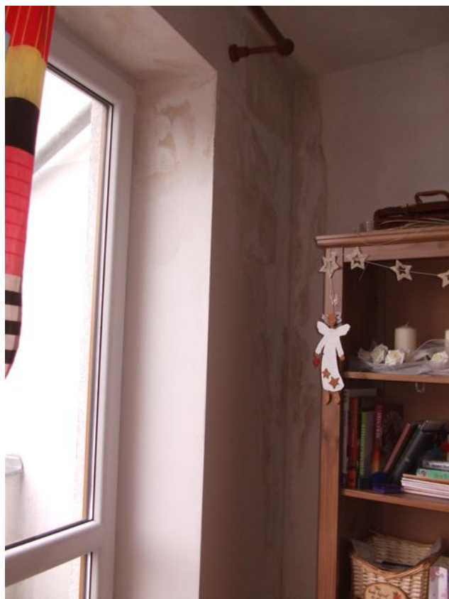
foto /216/ Projevy vlhkostních poruch v interiéru
