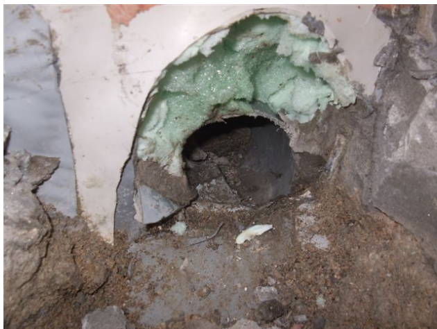
foto /228/ Použití nesystémového řešení, hydroizolační fólie jen vložena do potrubí
