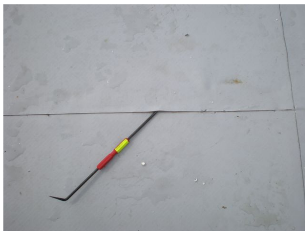
foto /85/ Nalezená netěsnost ve spoji hydroizolace
