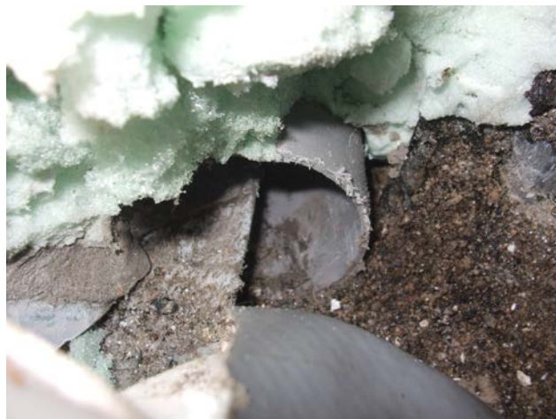
foto /229/ Nález vlhkosti pod hydroizolační fólií, netěsné napojení hydroizolace na potrubí
