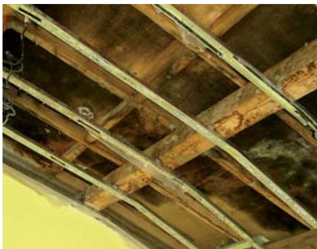
foto /113/ Napadení dřevěných konstrukcí dřevokaznými organismy; latě přerušující vzduchovou vrstvu
