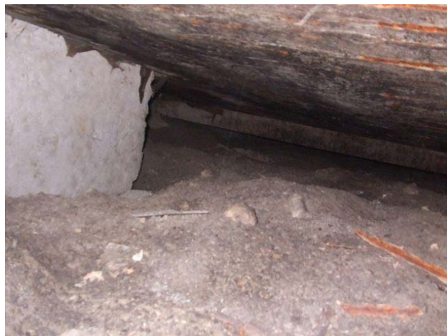
foto /94/ Pohled do provedené sondy s odpadávající výztuží z horního pláště střechy
