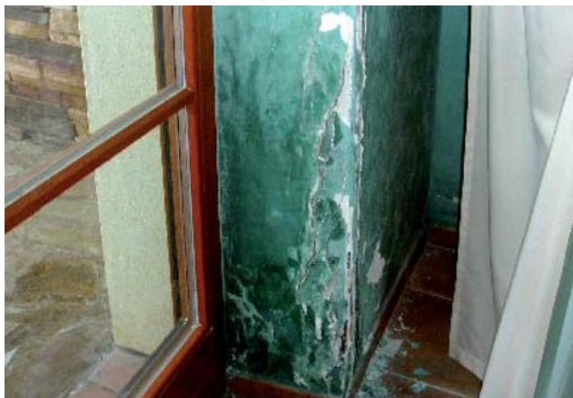
foto /4/ Vlhkostní projevy na stěně suterénu
