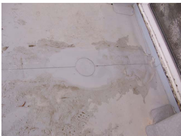
foto /90/ Místo s nalezenou netěsností opravené horkovzdušným navařením kruhové záplaty
