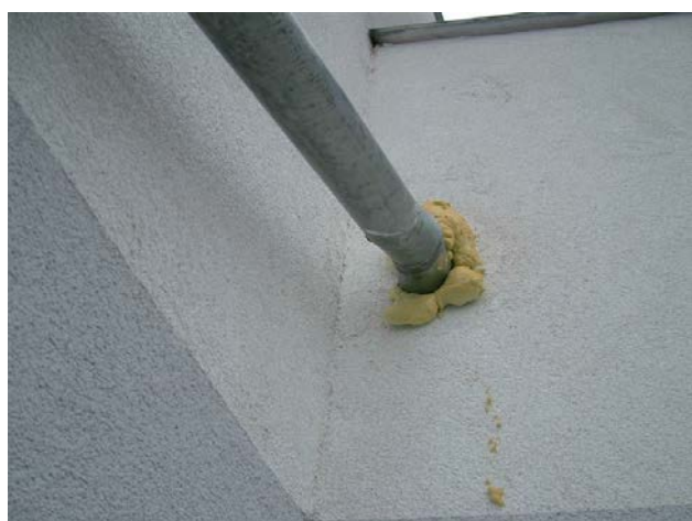
foto /238/ Reálné foto objektu - vstup dešťového odpadního potrubí
