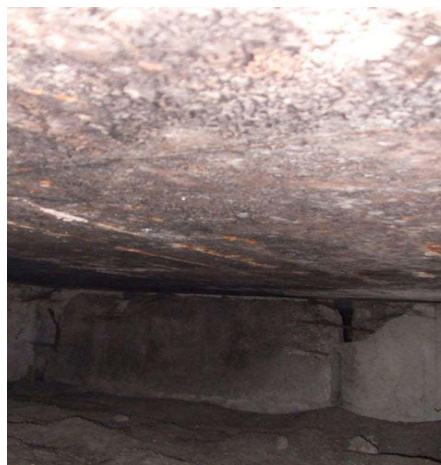
foto /96/ Pohled do vzduchové mezery v provedené sondě s odpadávající výztuží
