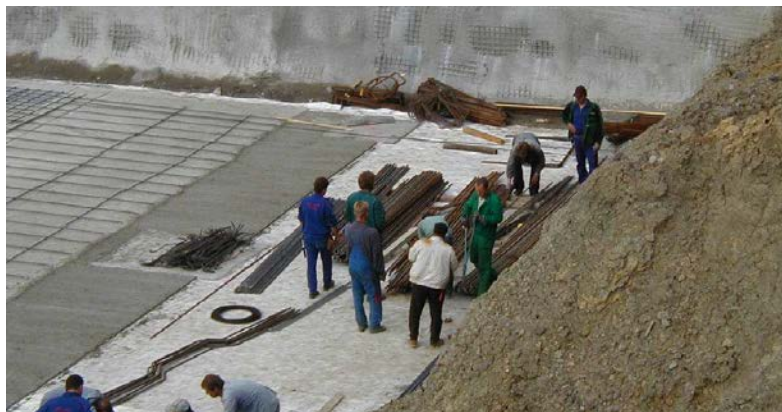
Obr. 6 – Nesprávné skladování materiálu - výztuž železobetonové základové desky je skladována na hydroizolaci chráněné pouze textilií (možnost poškození hydroizolační fólie výztuží)
