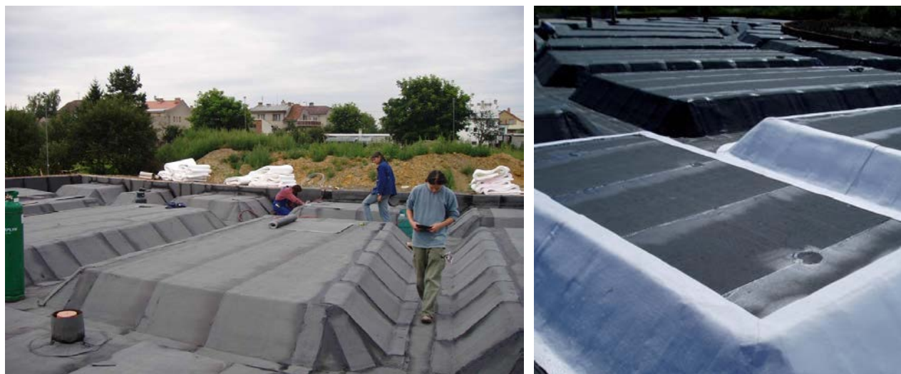
Obr. 13, 14 – Provedení hydroizolace spodní stavby z SBS modifikovaných asfaltových pásů (GLASTEK 40 SPECIAL MINERAL nebo ELASTEK 40 SPECIAL MINERAL)
