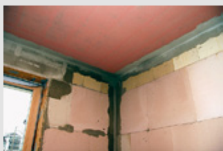
Styk zdiva v rozích a styk zdiva a stropu je opatřen stěrkou pro zajištění vzduchotěsnosti (ENVIC, o.s.)
