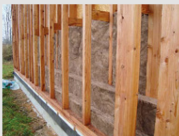
Nosná konstrukce z dřevěných sloupků, tepelná izolace z měkkých desek z minerální vlny (Centrum pasivního domu)
