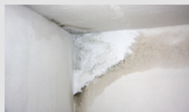
Jedním z projevů špatného větrání jsou plísň
